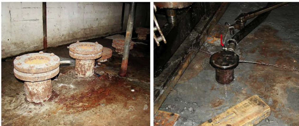
Рис. 4-21. Потери фильтрации через тело плотины ГЭС (шпунтовый коридор, пройденная скважина через бетонное основание плотины)
