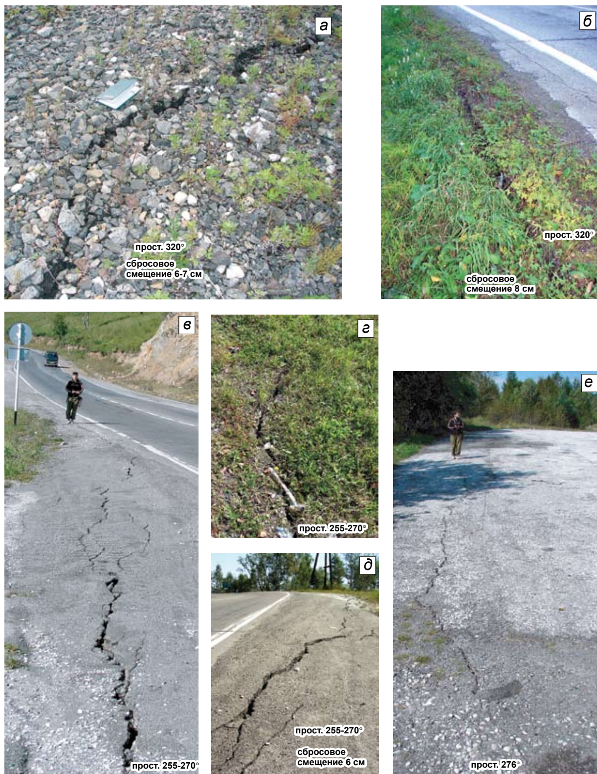
Рис. 5. Примеры проявления трещин в природных и насыпных грунтах: а – в железнодорожной насыпи в пункте OREKH_101, б – на границе асфальта и почвы в пункте OREKM_102, в, г, д – в старом асфальте и почве в пункте SLUD_101, е – в асфальте в пункте KULT_102
