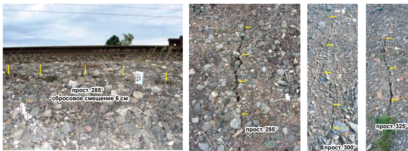
Рис. 4. Примеры проявления трещин в железнодорожной насыпи в пункте UTUL_101
